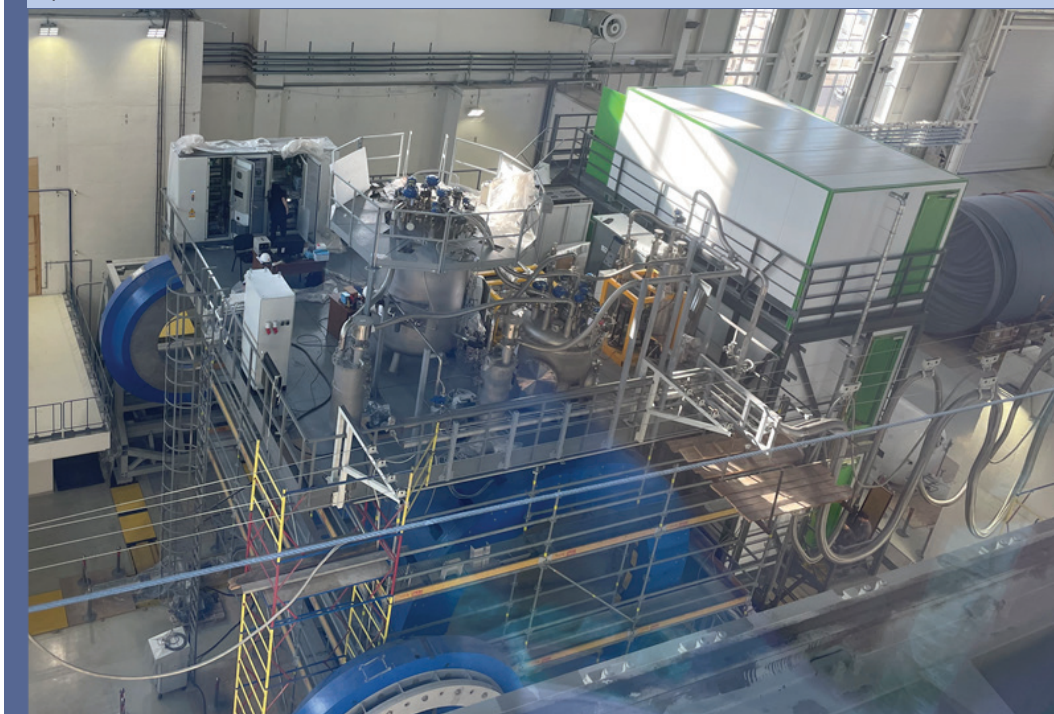
Общий вид технологической платформы с установленным оборудованием криогенной системы охлаждения соленоида MPD
